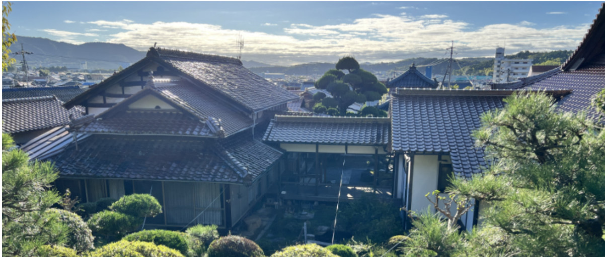
(上)左建物が雨漏りなどで悩まされている庫裏です。屋根を修理したとしても今後の使用方法に課題があり、事業実行委員会で建て替えを検討しています。
